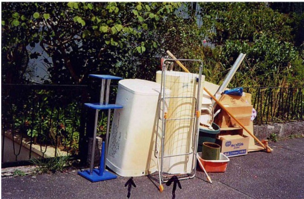
Abb. 1: Zwei total verkalkte Warmwasser-Boiler (Pfeile: 801 +1001; 2006) aus und vor dem Hause Goethestraße, 77855 Achern, zum Austausch nach nur 6 bzw. 8 Jahren Nutzungszeit (Instandsetzungskosten: 2.800.--€) – bedingt durch die sehr hohen Gesamthärte-Gehalte im Acherner Trinkwasser (vor 2008).
