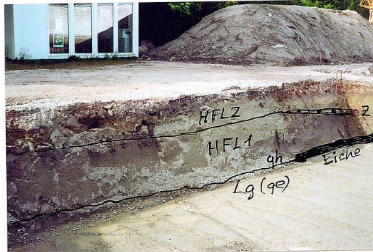
Abb. 3: Blick in die Baugrube Jahnstraße 7, Achern, mit der holozänen Auenlehmdecken (HFL 2 und HFL 1), der Lage der Holzkohleschicht mit Zwetschgen-Kernen (= Z, Profil-mittig rechts) und der Eichenstämmen (Holozän-Basis, qh), erosionsdiskordant lagernd auf elsterzeitlicher Grundmoräne, Lg/qe (Foto: Prof. Dr. D. ORTLAM, Bremen).
